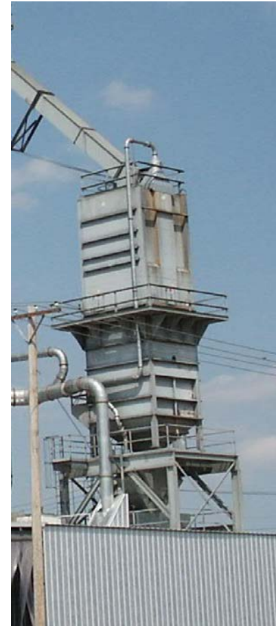
Tolvas con fugas
