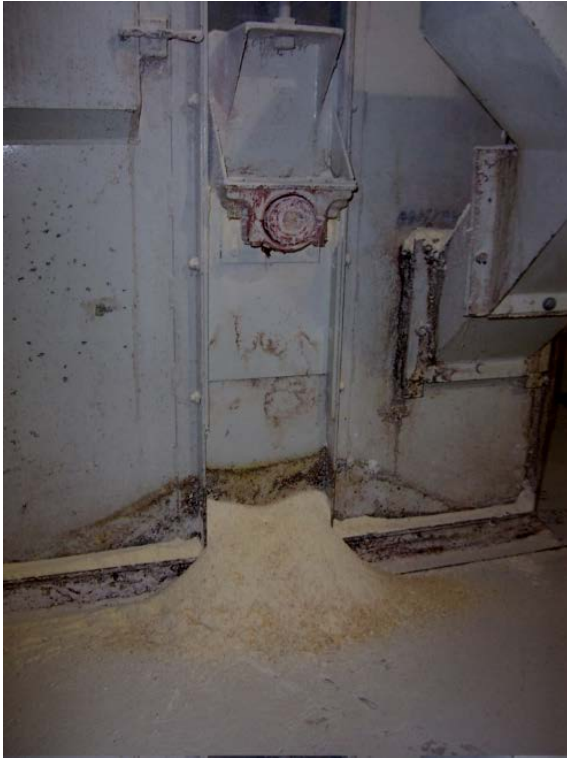
Fuga en base del elevador
